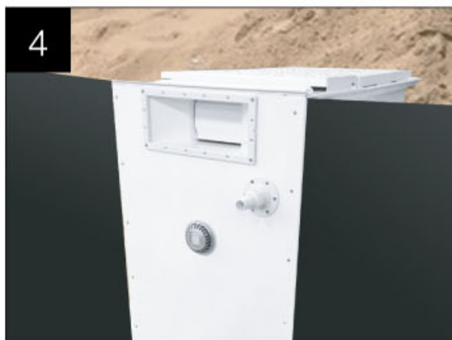
4 TE Filter Installation ติดตั้งเครื่องกรองอัจฉริยะ
