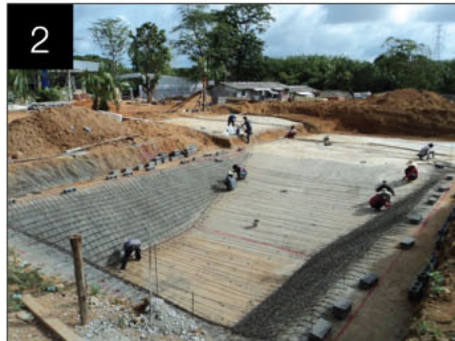
2 Reinforced Rebar Slab and Levelling Blocks เทเส้นพื้นสระ และวางเหล็กเส้น
